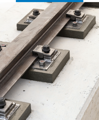
Anclaje de un riel para una grúa aérea
