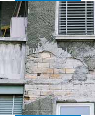
Edificio degradado que precisa de una restauración
